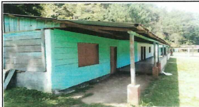
Foto 4: Pared, ventanas, puertas y columnas de maderas totalmente deterioradas en su estructura, necesitan de bastante reparación.
