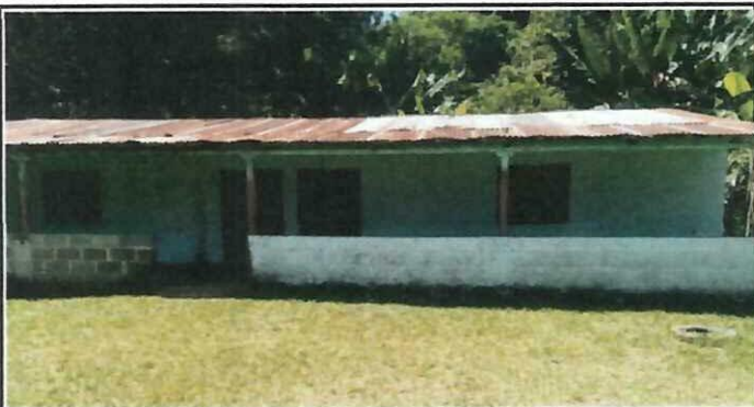
Foto 1: Parte frontal del establecimiento que necesita remozamiento, con severos daños y deterioro en su estructura, que indica que no está en un estable aceptable.
