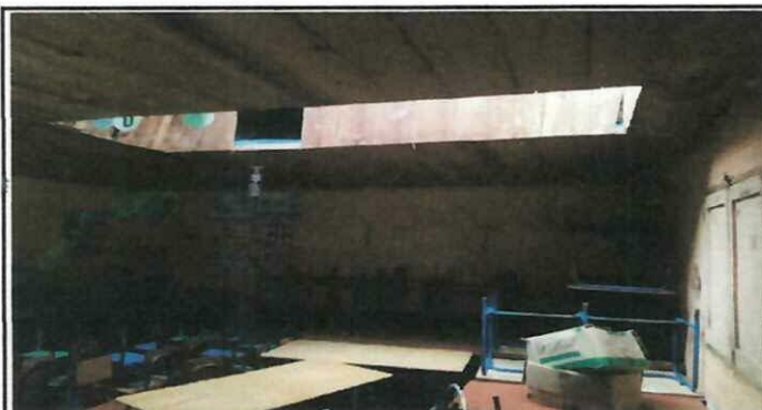
Foto 3: Techo y cielo falso de madera que se desmorona, que en sus totalidad no reúne las condiciones necesarias para ser utilizadas.
